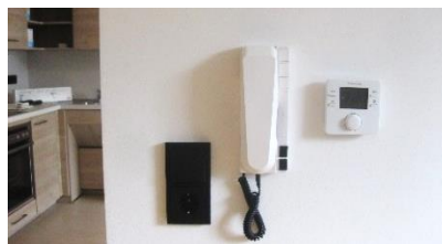
Sprechanlage im Wohnzimmer
